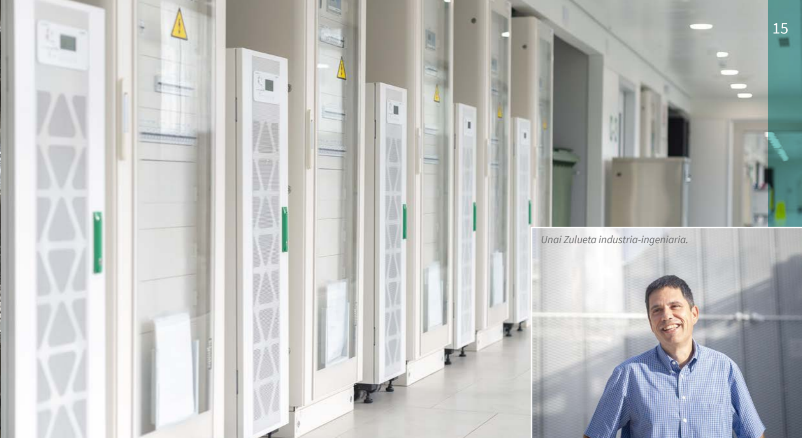
Koadro elektrikoak eta etenik gabeko elikadura elektriko sistemak.
